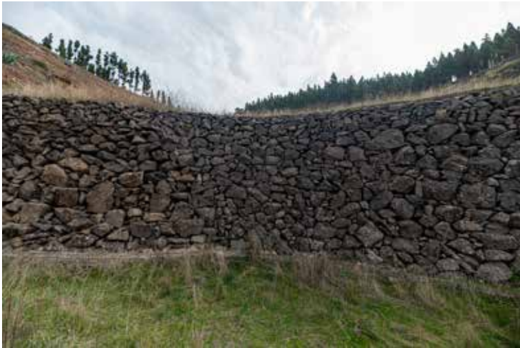
Figura 1: Muro de piedra seca de aprox. 5 m. de alto en la finca de Los Lavaderos
